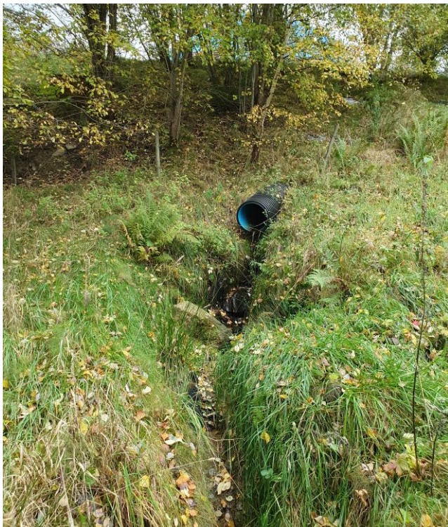
Figur 23. Foton på dräneringsrör direkt öster om industrin, där det pågår erosion.
