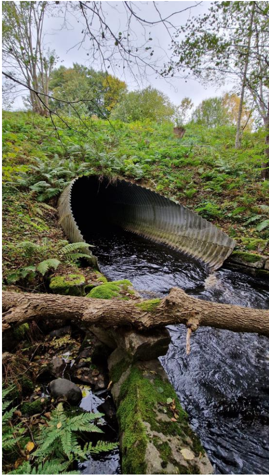
Figur 18. Foto på trumman nedstöms, på Hjälvägens östra sida, där erosionen under trumman delvis är synlig.
