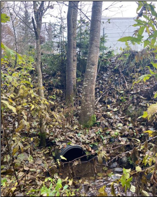
Figur 27. Trumma under grusväg med utlopp i Hökesån. Bildkälla: Habo kommun
