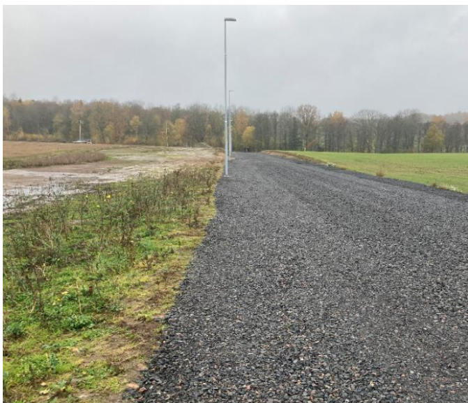
Figur 12. Bild av planområdets nordligaste belägna lokalgata, bild tagen i västlig riktning. Stående dagvattensamlingar kan urskiljas intill vägen
